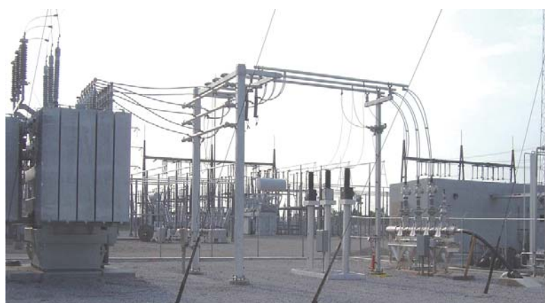
图6. 俄亥俄州哥伦布 AEP 电网 Bixby 变电站 13.2kV、3000 A rms HTS 电缆安装 (Southwire 供图)。
