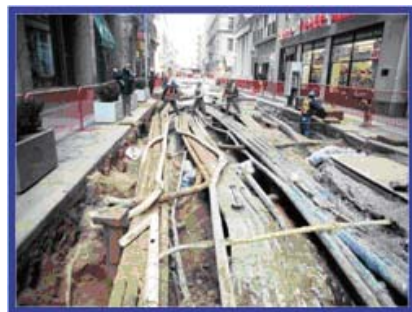
图4. 曼哈顿区几英寸下的地下设施。密集的地下设施阻止进一步的扩展的可行性 (Con Edison 供图)。
