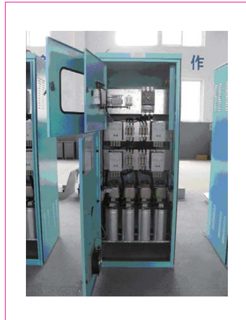
图 2. CSSC 的动态 PFC 设施。 上：带有熔断器的终端单元 中：可控硅模块 下：失谐 PFC 电容器 PFC 控制器安装在门上
